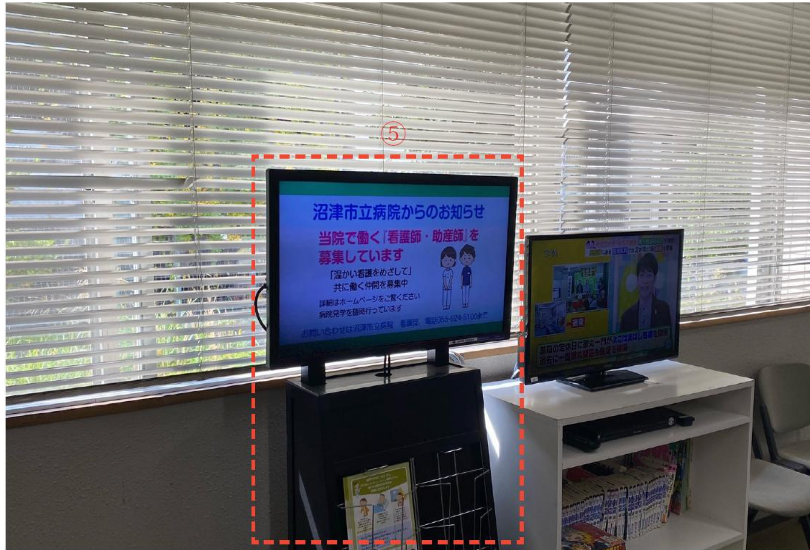
現在のモニター設置状況〈1階 内科待合 東〉⑤ 32インチ
